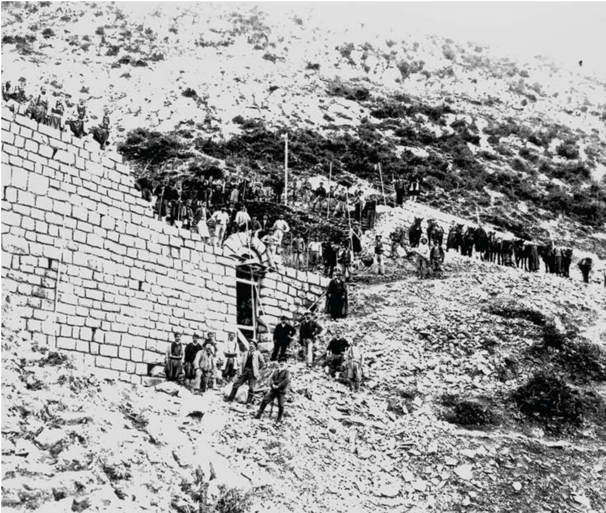
2. Izgradnja potpornog zida i propusta za vodu u Sutorini na trasi pruge Gabela - Zelenika
